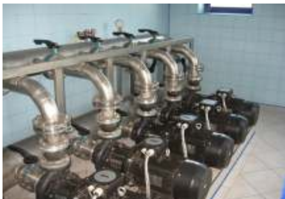
Stacja Uzdatniania Wody – Września: pompownia III stopnia
