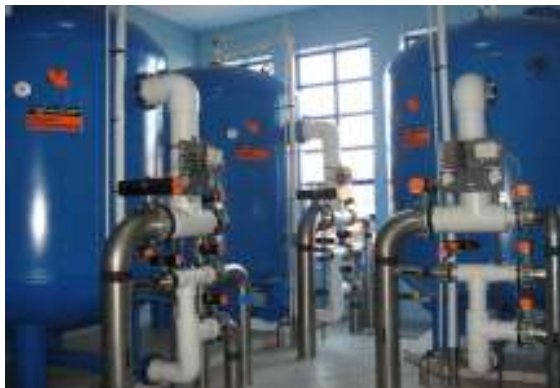
Stacja Uzdatniania Wody – Września: zbiorniki filtracyjne
